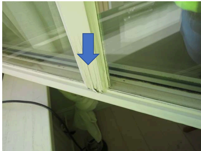
Fönster i behov av underhåll
