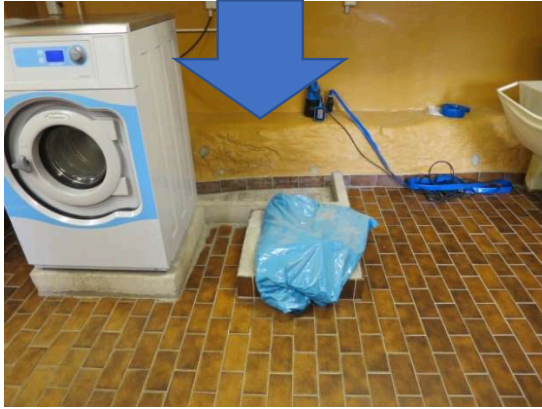
Fuktskador i uk vägg
