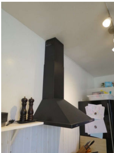
Kolfilterfläkt i kök
